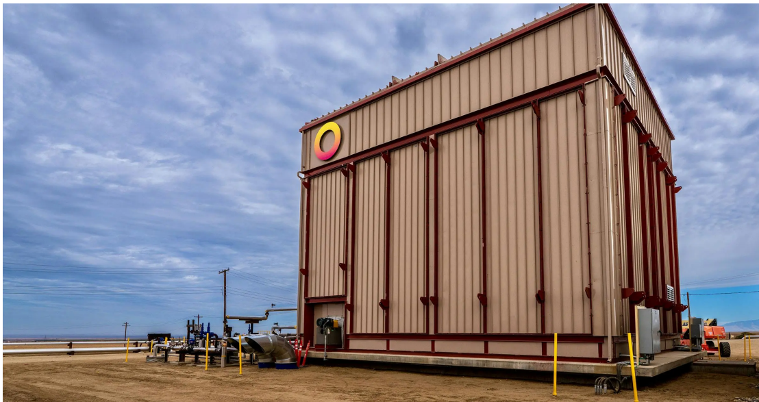
Rondo pone en marcha la batería de calor industrial más grande del mundo
