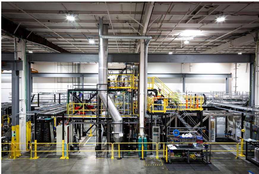
Zap Energy acerca la energía de fusión a su comercialización con una plataforma de investigación única
